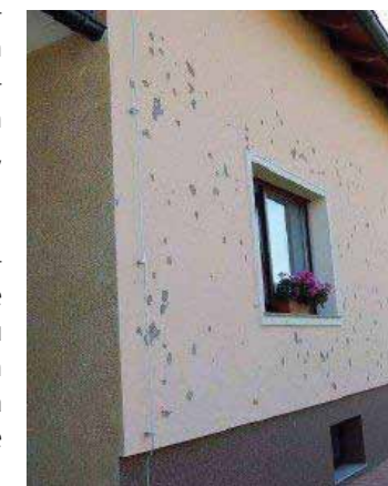
Oštećenja fasade (izvor: ZAG Ljubljana).
