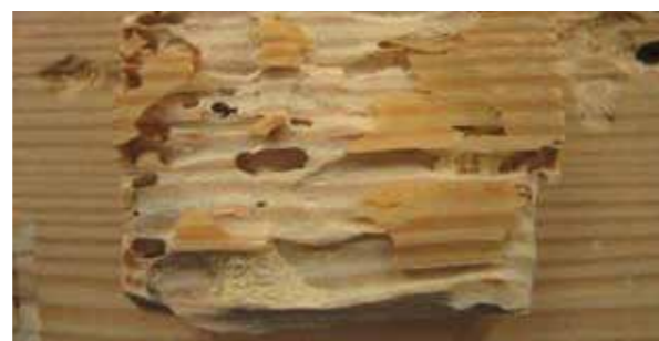
Na slici je prikazano oštećenje drva, nastalo zbog napada kućne strizibube.
